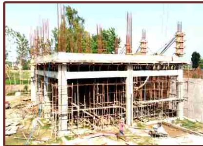
ब्लोवर रूम एवं एडमिन बिल्डिंग
