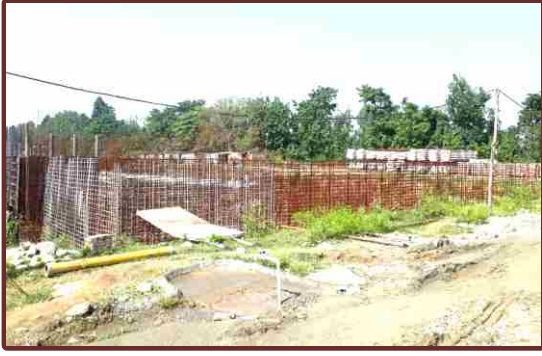
क्लोरीन कोन्टेक्ट टैंक
