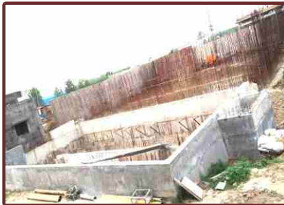
क्लोरीन कोन्टेक्ट टैंक
